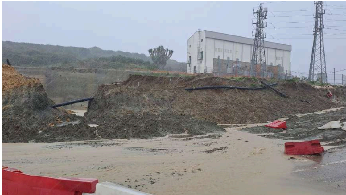
Las obras del Acceso Sur, donde se ha roto una tubería de abastecimiento para Getares.
